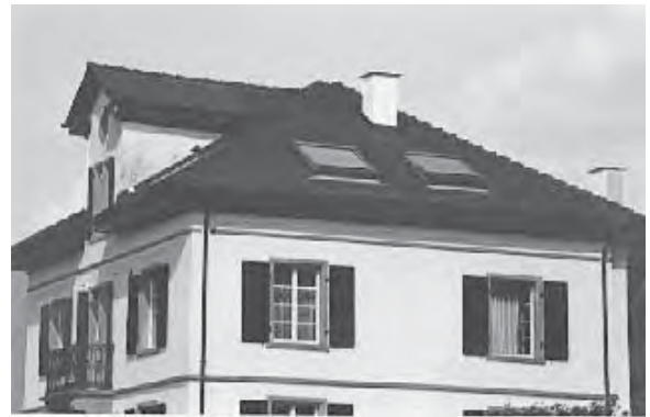
Schlecht: Dachfenster bilden Löcher in der Dachfläche. Quergiebel zu hoch angesetzt.
