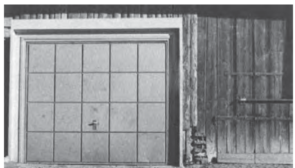
Schlecht: in Material und Gestaltung fremd wirkende Tore an Altbauten
