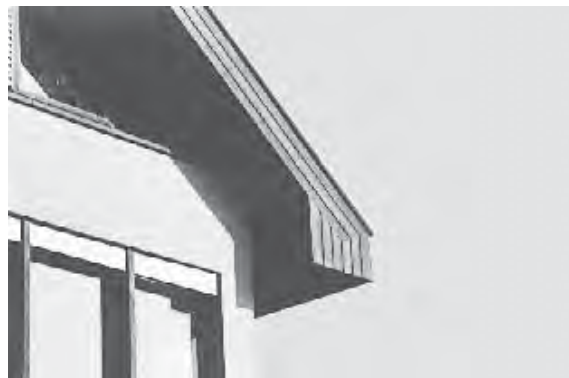
Falsch: zu massives Ortgesimse, bündig mit Dachfläche
